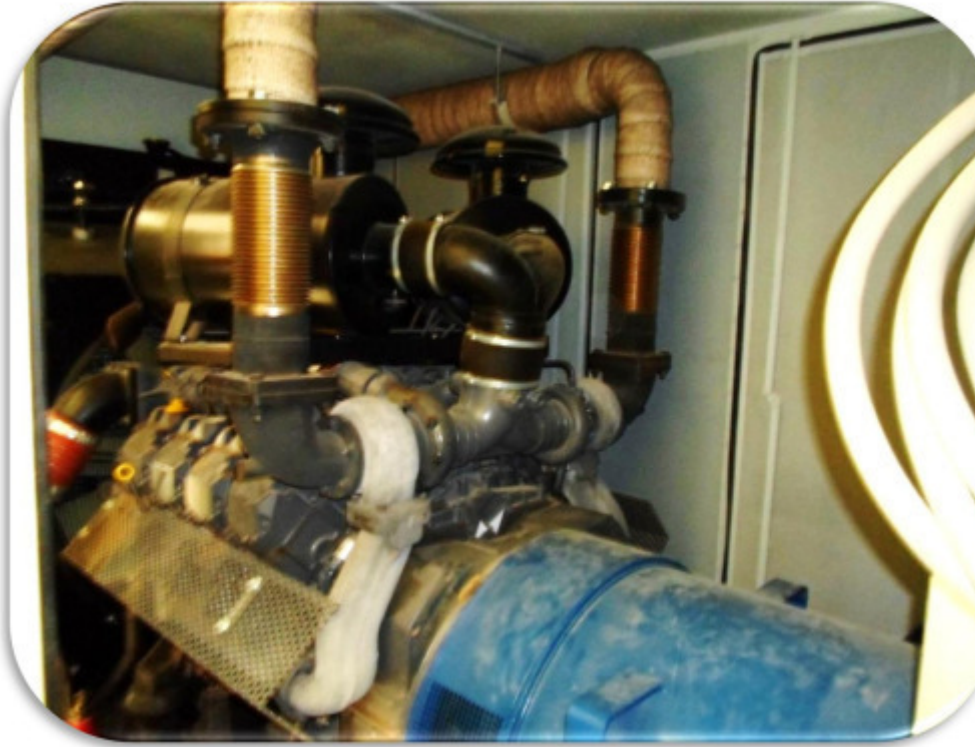
Figure 6: Groupe électrogène 350-DG-01
