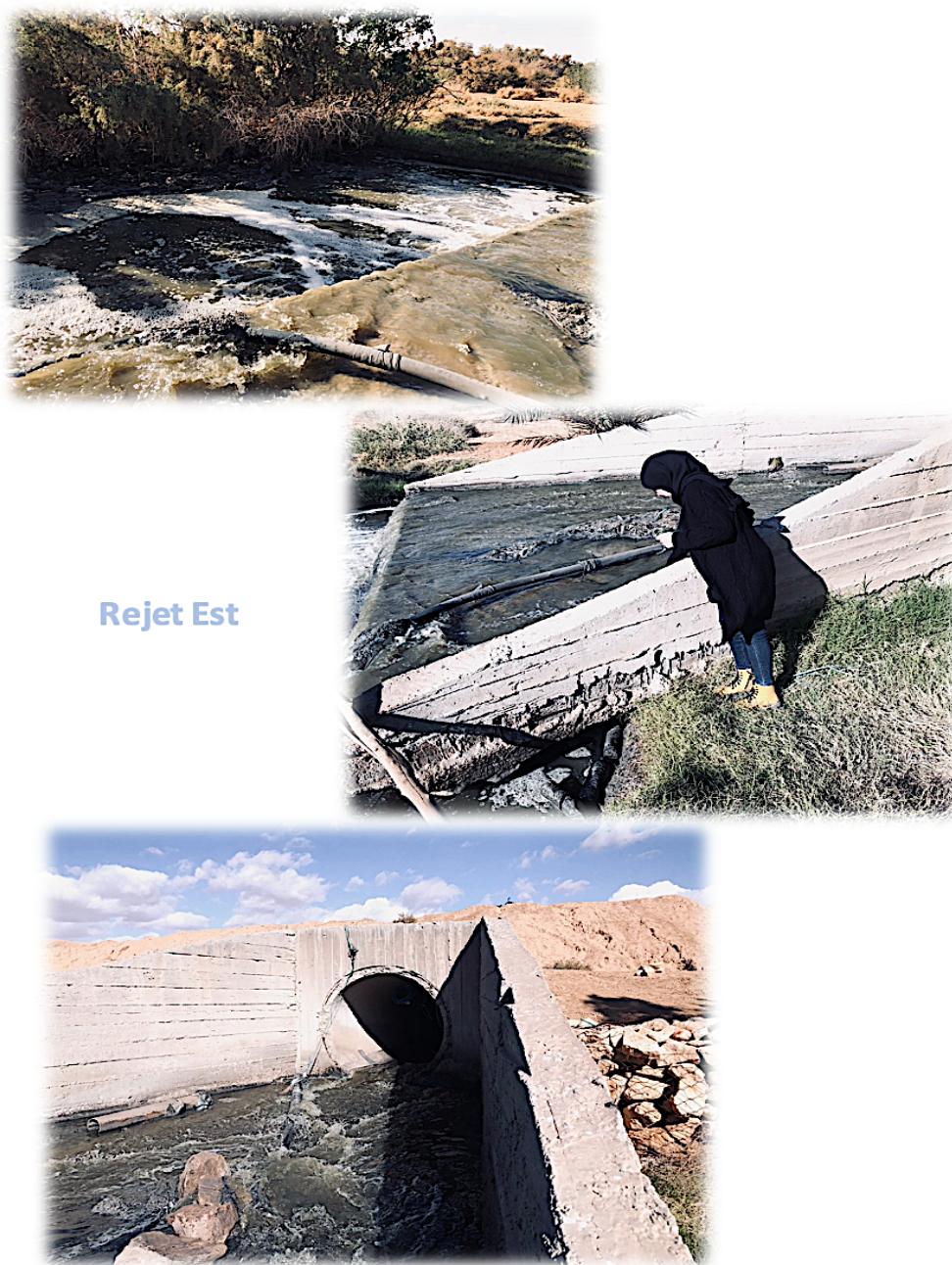
Figure 13: Site III-Rejet Zone Est (Photos prises le 06 Décembre 2021)
