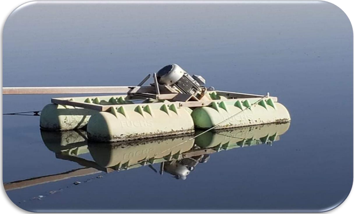
Figure 21 : Aérateurs (Pompe d'aération).
