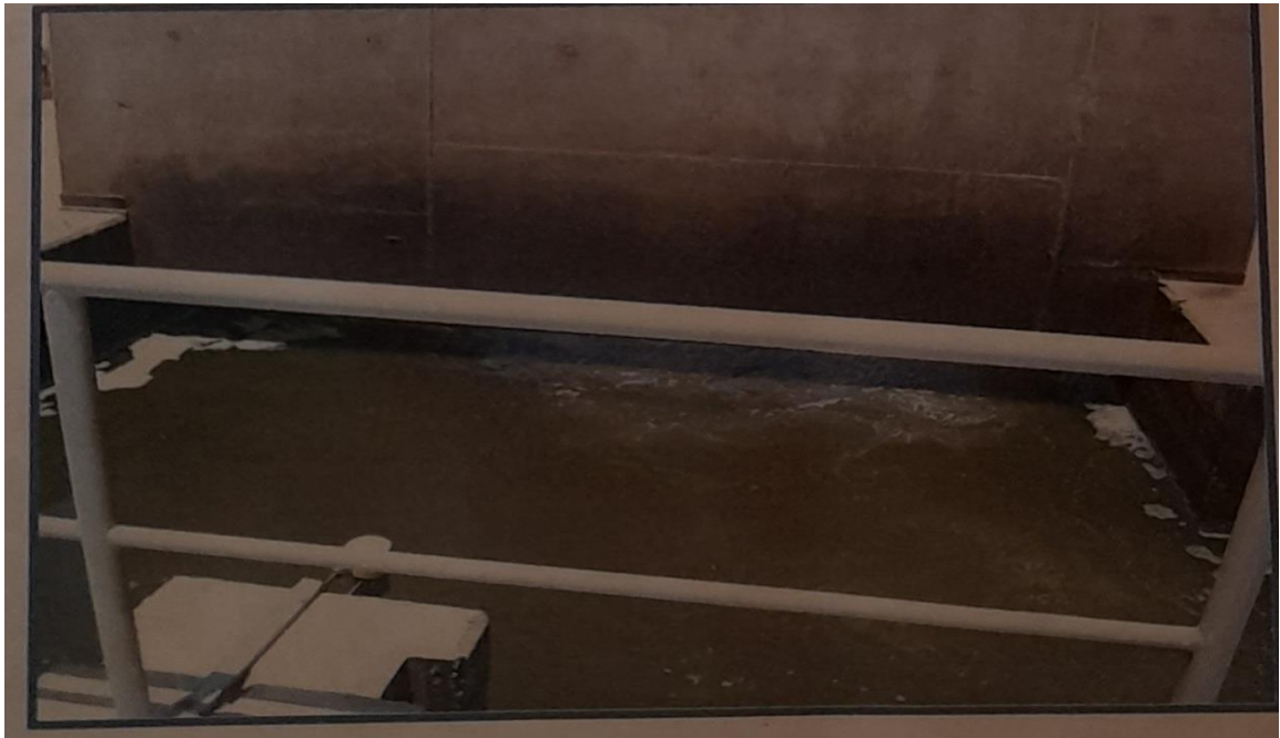
Figure 17 : L'entrée des eaux usées a la station.
