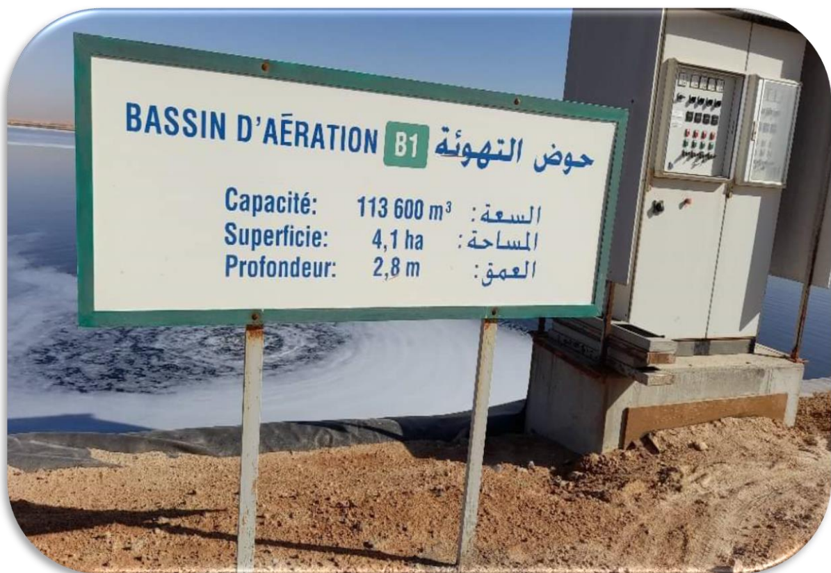
Figure 22 : Lagunes aérées des bassins B1.
