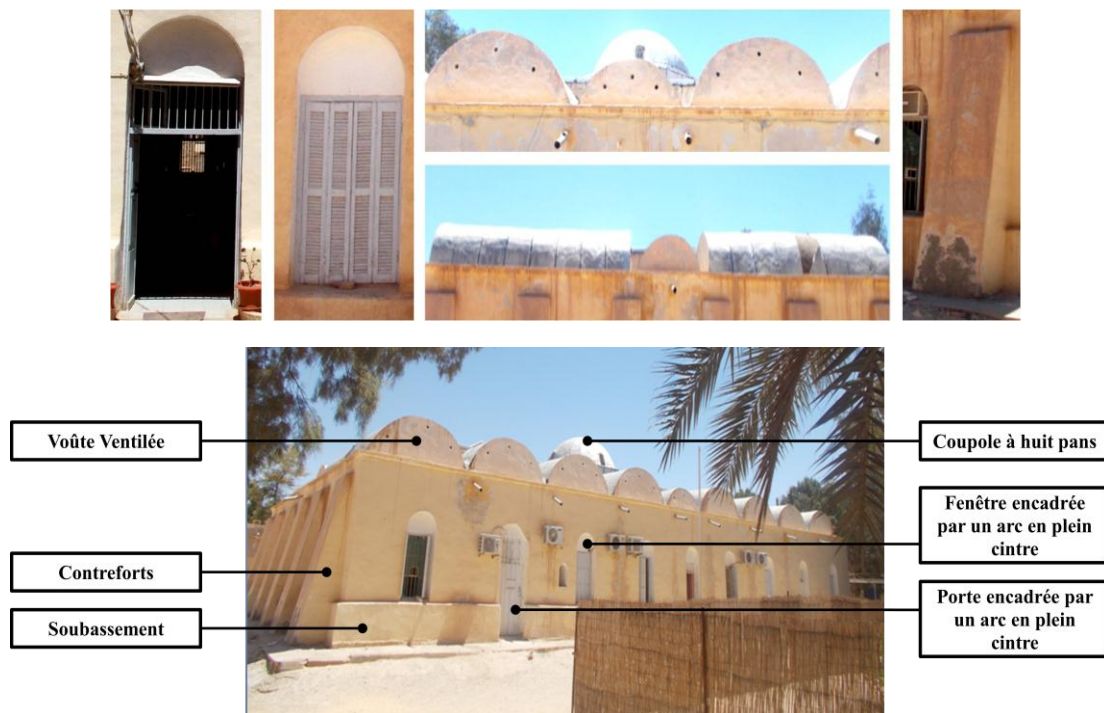
Figure VII-46 : Eléments de la façade de l'Ouvroir des Sœurs Blanches –Touggourt- Source : Auteur.
