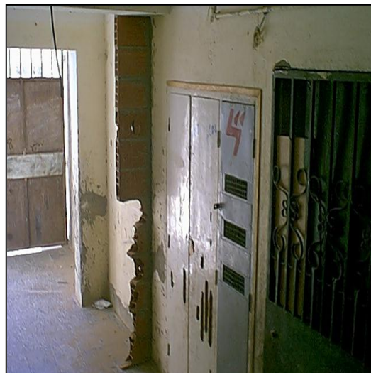
Photo.69: Dégradation des murs cité 600 logements
