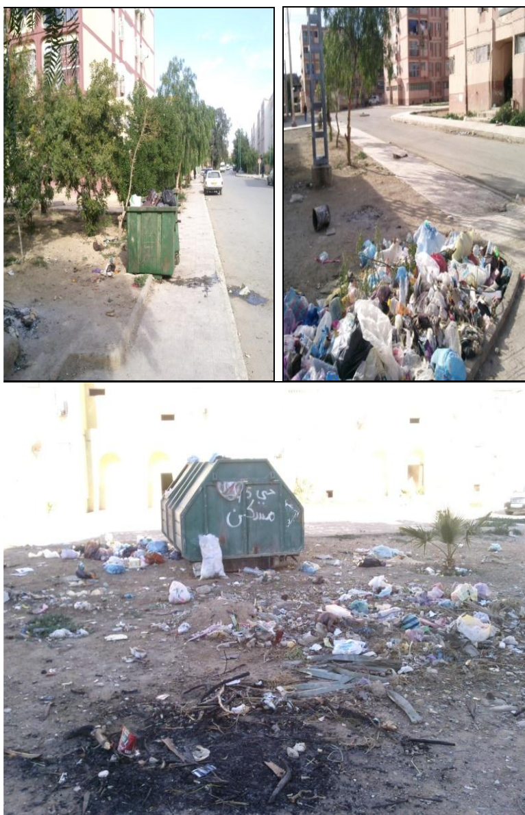
Photo.59 : Mauvais entretien des espaces extérieurs
