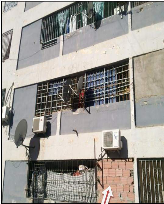
Photo.33: Fermeture d'une partie du balcon en brique
