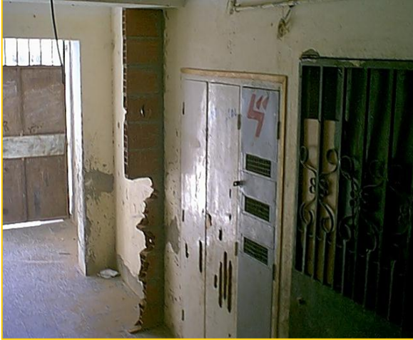
Photo.56: Apparition des fissures
