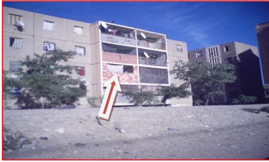
Photo.22: Des surélévations des murs des balcons sans tenir compte du type de matériau utilisé.
