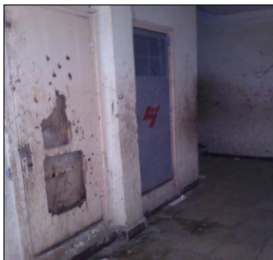
Photo.68: Peinture écaillée cité 206 logements
