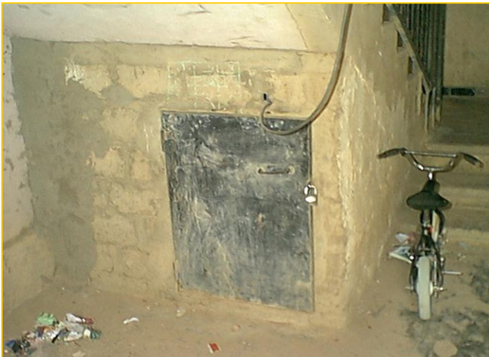
Photo.58: Rejet d'ordure à l'entrée du bloc
