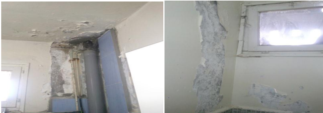
Photo.3: Effet d'humidité sur murs et plafonds des pièces sanitaires
