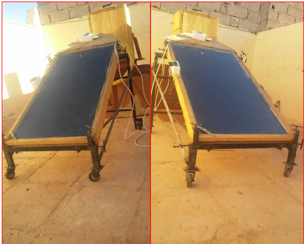
Figure IV.1. Photos de l'installation complète
