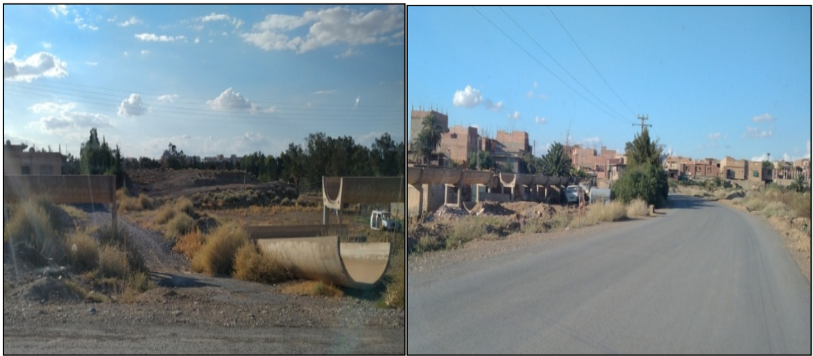
Photo 22: la détérioration du réseau d'irrigation
