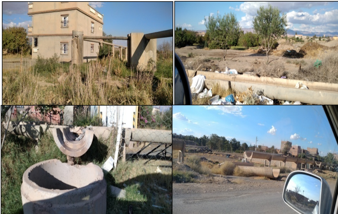
Photo 10: La dégradation des réseaux d'irrigation
