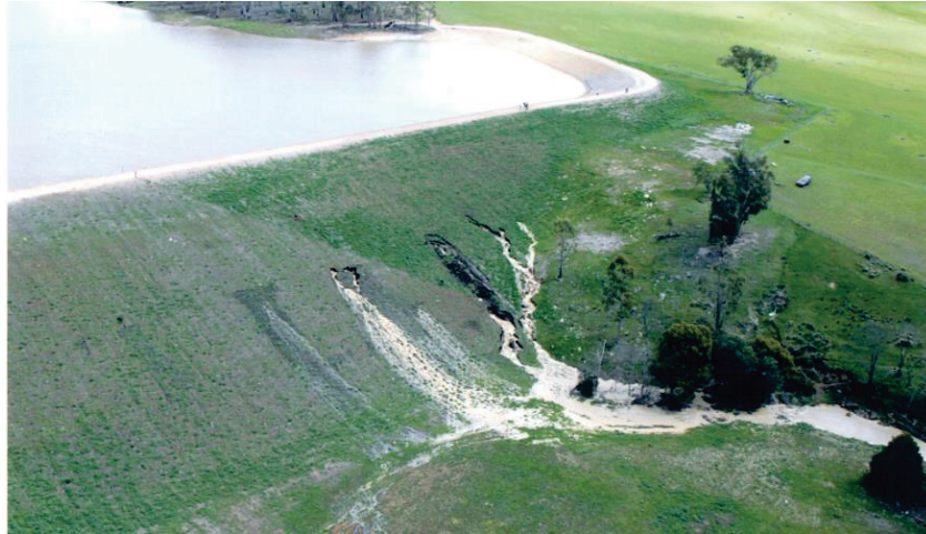
Fig. 7 Érosion interne (phénomène de renard), barrage de Tunbridge, Tasmanie, Australie. (Jeffrey A. Farrar 2005)
