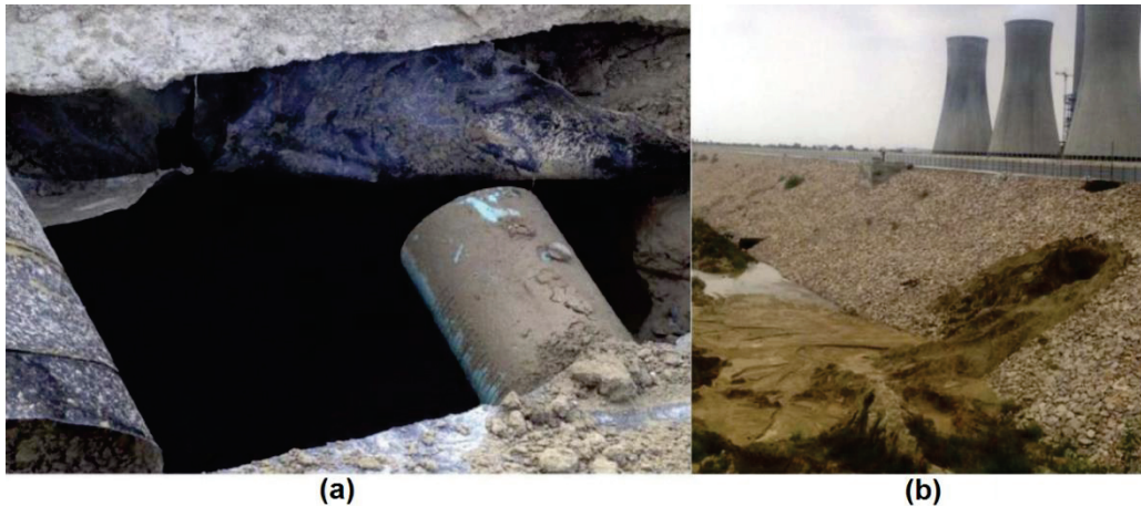
Fig. 6 (a) Le sol emporté sous la géomembrane déchiré autour des drains latéraux, (b) Dommages dans le remblai. (Bhowmik et al. 2018)
